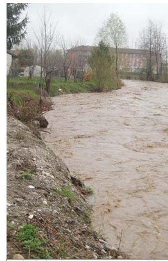
Argini del Mellea: sono da rifare
